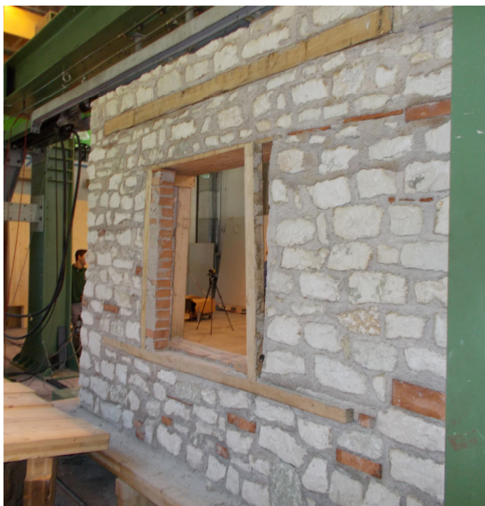
Fig. 66 Retro del modello con evidenziato in primo piano la fuoriuscita dalla muratura della membratura lignea orizzontale dovuta a instabilità per compressione eccentrica.
