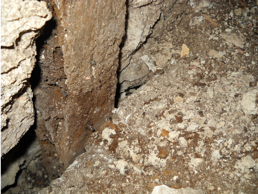
Fig. 88 Avanzato stato di degrado dell'attacco montante trave del solaio dovuto ad attacco biotico.
