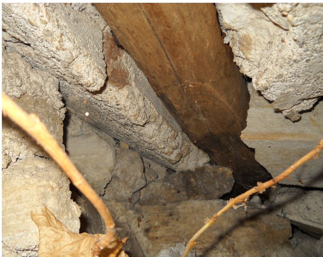
Fig. 90 Fori di sfarfallamento nella membratura interna alla muratura.
