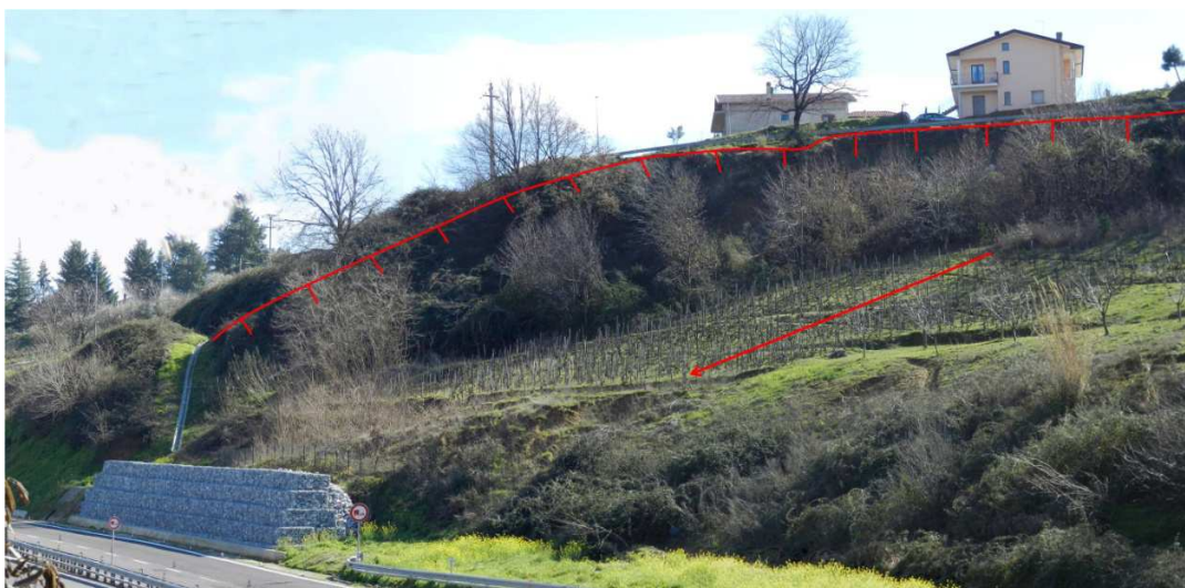
Figura 4.30 Frana attiva sul lato a monte dell'autostrada.
