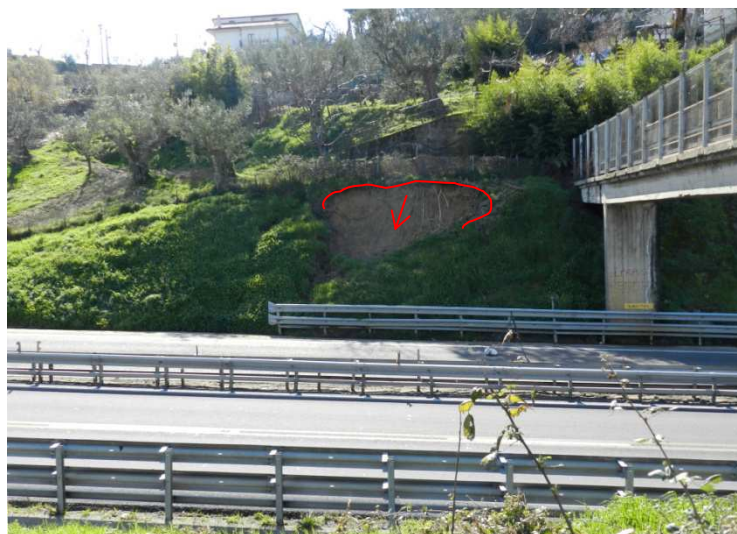
Figura 4.55 Restringimenti di carreggiata a causa di movimenti franosi sul tratto di autostrada considerato.
