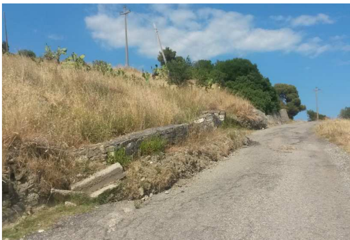
Figura 5.50 Danni alle strade causati da movimenti gravitativi.
