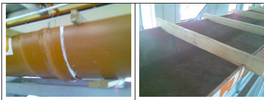
Figura 48: Particolare giunto tubazione di deflusso, dei puntoni in legno e della sabbia
