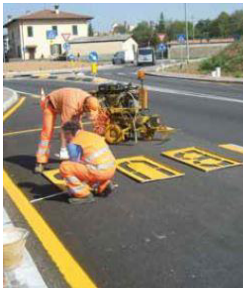
Figura 23 - Segnaletica Fermata Bus
