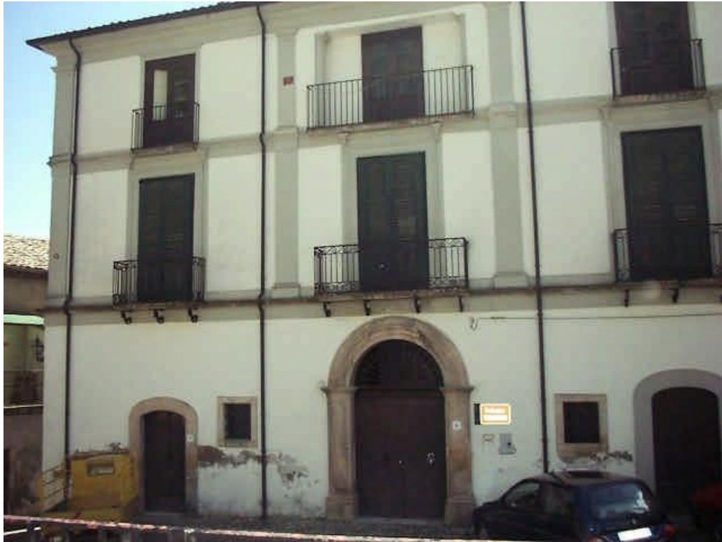
Figura 109. Domanico. Palazzo Stancati. Si eleva su tre livelli. Al piano terra si trovano il portale con stemma in pietra ed una finestra. Conserva quattro balconi in semplice ferro battuto al primo piano, mentre due finestre ed un balcone al secondo.
