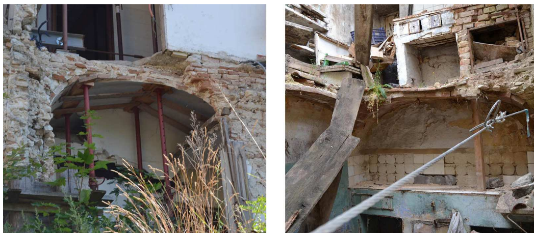
L'Aquila: comportamento delle volte leggere in mattoni in foglio.
