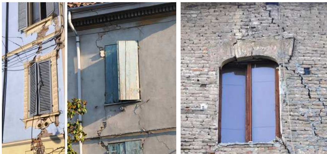
Collapsi delle fasce di piano a Mirandola (figura da PENNA A. 179).
