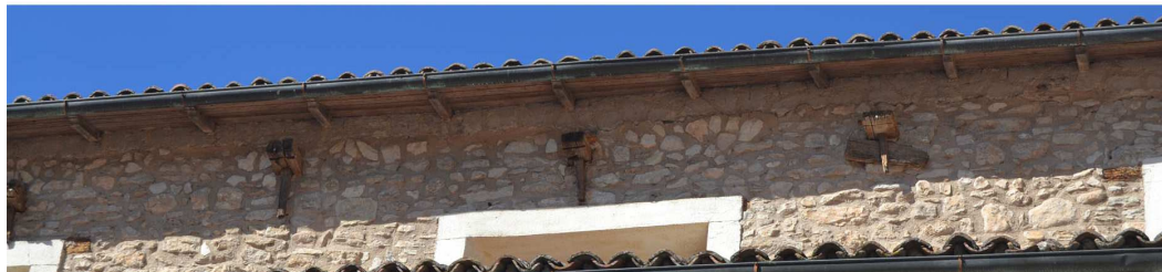
L'Aquila: capriata impalettata .
