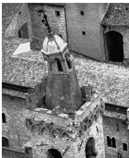
Foligno: campanile danneggiato.
