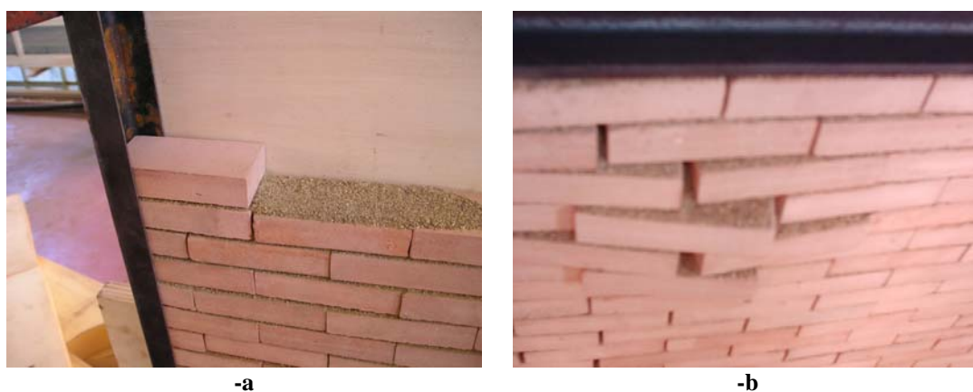
Fig. 5.17: Pannello murario realizzato con interposizione di sabbia fine nei letti orizzontali. -a: Particolare dei giunti orizzontali; -b: Scorrimento dei blocchi per perdita di attrito.
