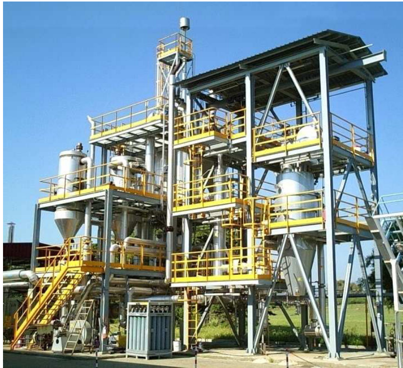
Figura 9.2 Foto dell'impianto a doppio letto fluido ricircolante denominato "Joule" da 500kWth I risultati sperimentali effettuati sull'impianto mostrano che la qualità del gas prodotto è paragonabile a quello ottenuto su scala industriale con l'impianto di gassificazione a Güssing [26].
