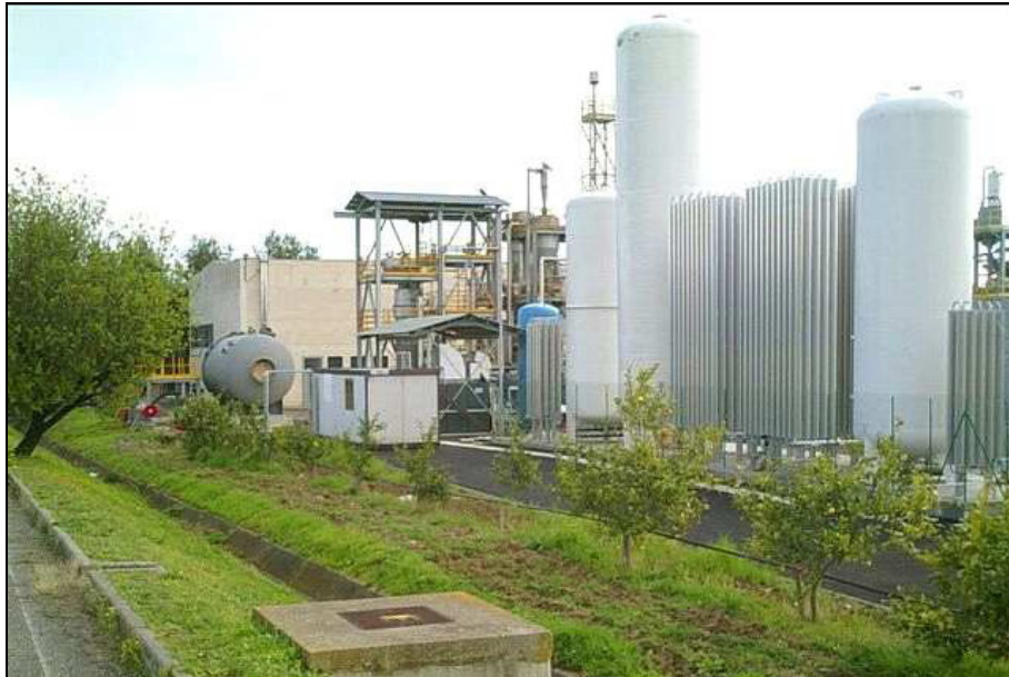
Figura 9.3 Stato attuale dell'impianto di gassificazione accoppiato all'impianto a celle a combustibile a carbonati fusi
