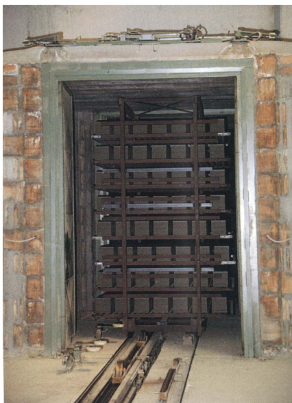
Figura 1.42 – Ingresso di un carro in un essiccatore a tunnel
