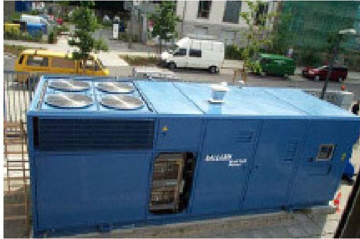
Figura 2.4: Impianto Ballard 250 kW
