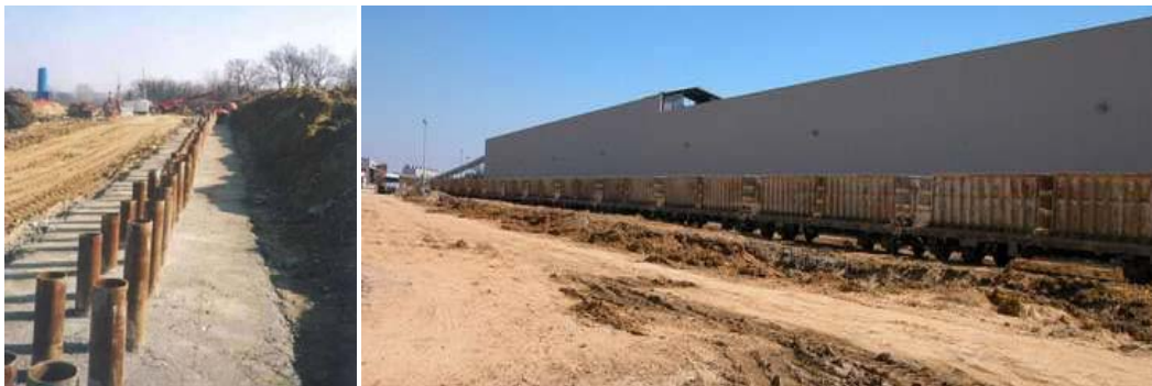
Figura 3.12 – Esempi di utilizzo degli aggregati riciclati in calcestruzzi a bassa resistenza e come materiale granulometrico per sottofondo ferroviario
