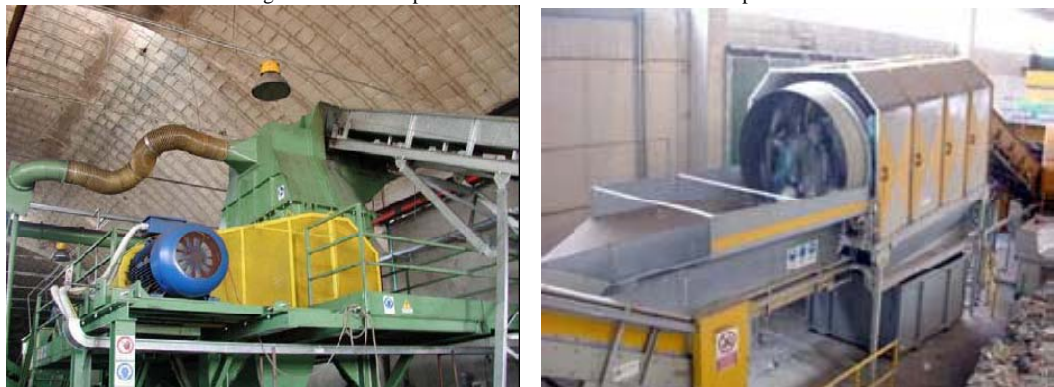
Figura 1.17 – Esempi di granulatore primario e di vaglio rotante
