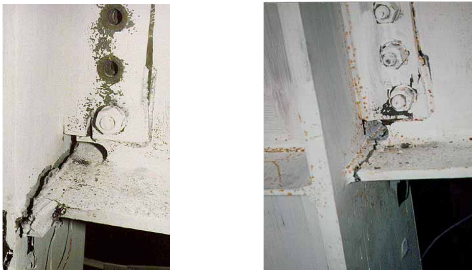
Figura 2.12 Esempi di danneggiamento del nodo trave-colonna per travi composte.
