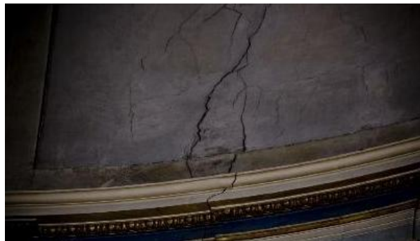
Figura 54 Importante fessura all'altezza del tamburo della cupola della Chiesa
