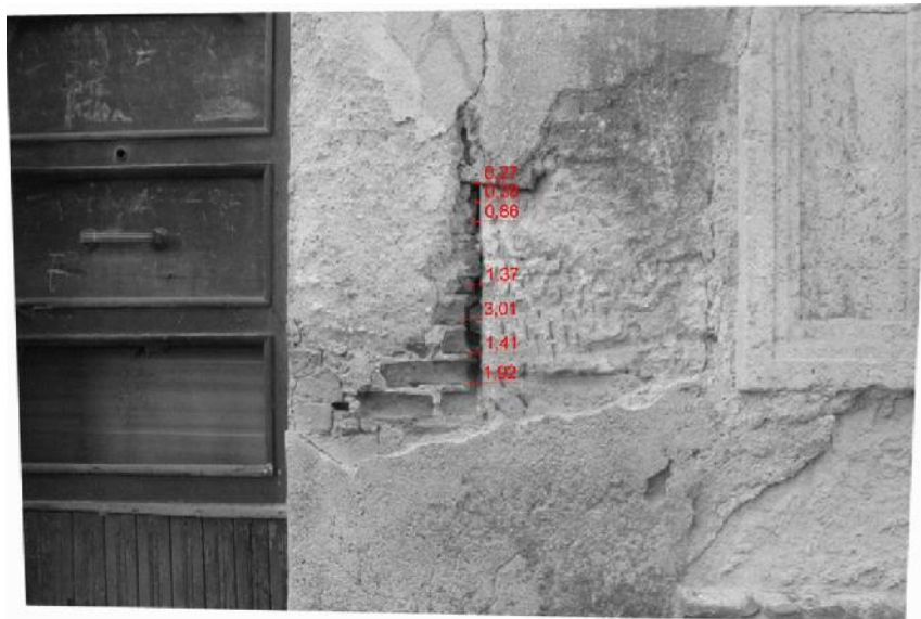
Figura 41 Dimensioni di una lesione in cm su fotoraddrizzamento
