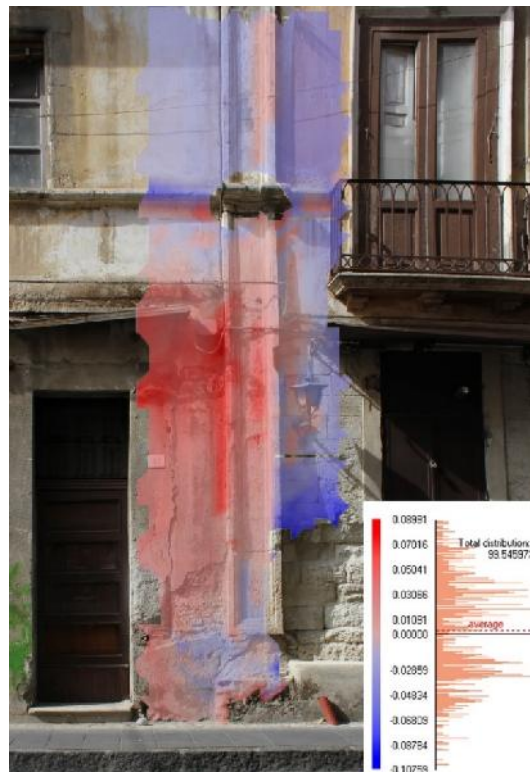
Figura 42 Rigonfiamento in facciata
