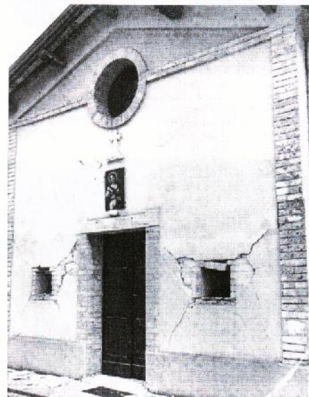
Figura 35 Edificio con lesioni provocate da meccanismi di secondo modo
