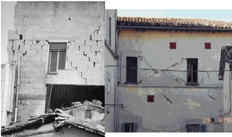
Figura 22 Esempi di tipici quadri fessurativi dovuti a meccanismi di danno di secondo modo nei maschi murari nei terremoti di Calentini (1990) e di Nocera Umbra (1997)
