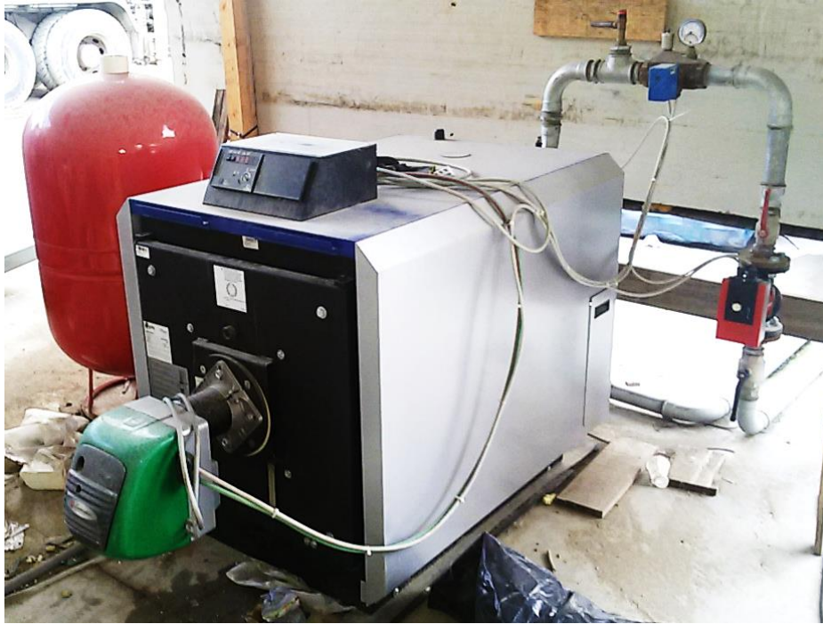
Figura 4.24. Caldaia alimentata a gpl per circolazione e riscaldamento acqua in fase test.
