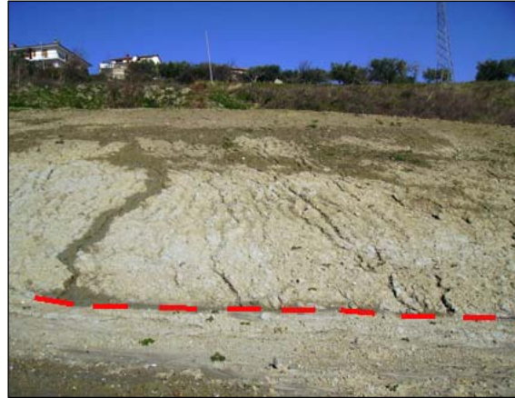
Figura 3.3 –Versante interessato da intensi fenomeni di erosione per rivoli. Al di sotto la linea tratteggiata si può osservare la fascia di depositi colluviali prodotti dall’evento.
