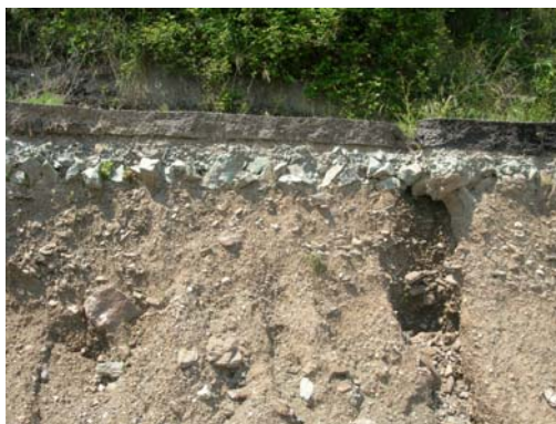
Figura 2.20 – Depositi di falda detritica al di sotto del manto stradale, affioranti lungo la scarpata di frana che ha interessato l'abitato di Cavallerizzo nel mese di marzo 2005.
