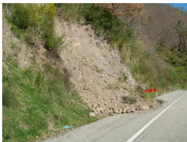
Figura 3.19 –Frana da crollo su roccia metamorfica fratturata ed alterata, lungo la strada che collega Mongrassano a Cavallerizzo.
