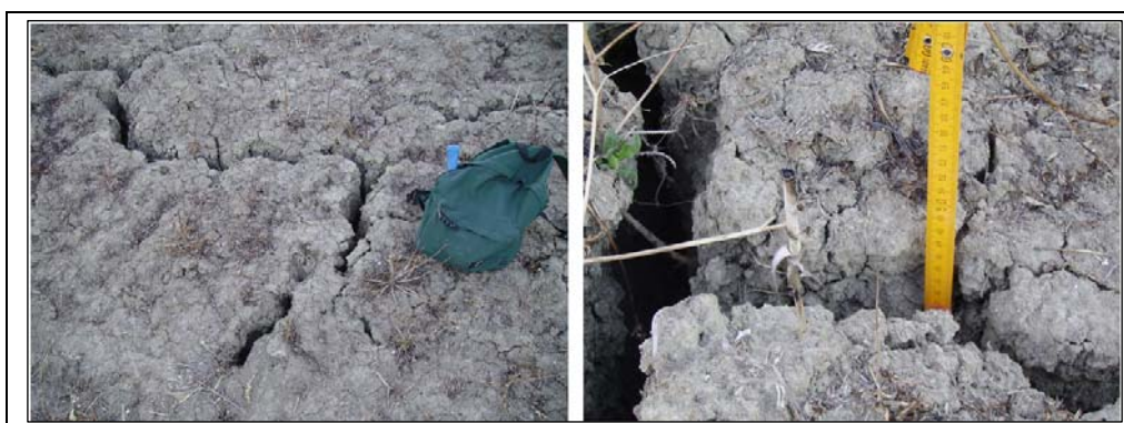
Figura 3.14 –Evidenti fenomeni di fessurazione delle argille che raggiungono la profondità di quasi 50 centimetri.
